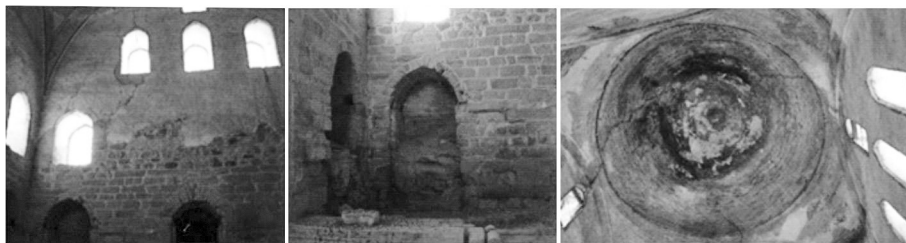
Εικ. 5: α. Μέρος εσωτερικής τοιχοποιίας, β. Διάβρωση των υλικών δόμησης, γ. Παρουσία ρωγμών και βιολογικής προσβολής στον θόλο.
