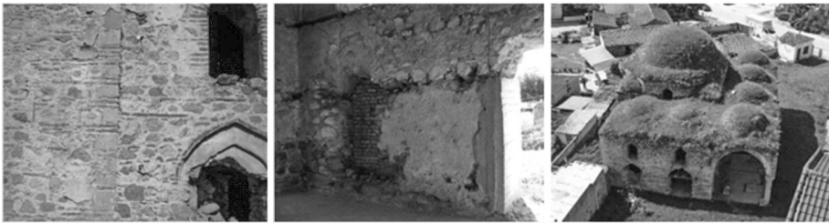
Εικ. 7: α. Εξωτερικός αρμός σύνδεσης των τοιχοποιιών, β. επεμβάσεις στο εσωτερικό του μνημείου, γ. άποψη της κατάστασης διατήρησης της επίστεψης του τεμένους.
