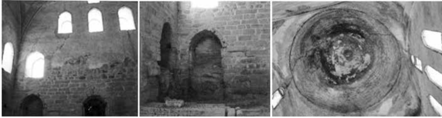
Εικ. 5: α. Μέρος εσωτερικής τοιχοποιίας, β. Διάβρωση των υλικών δόμησης, γ. Παρουσία ρωγμών και βιολογικής προσβολής στον θόλο.
