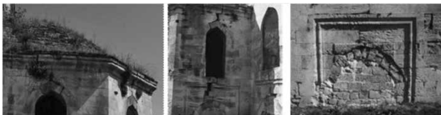
Εικ. 4: α. Λεπτομέρεια της κόγχης του μιχράμπ, β. ρωγμές σε άνοιγμα της όψης, γ. κλειστό άνοιγμα με σύγχρονα υλικά.
